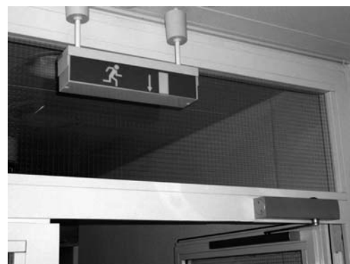
Bild 6: Beispiel einer Notbeleuchtung
